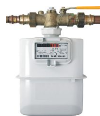
Compteur de gaz
